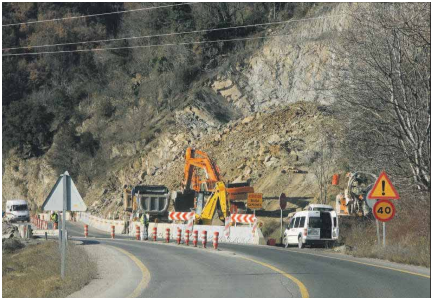
Treballs per iniciar les obres de millora de l'N-145, que ara quedaran interromputs.
